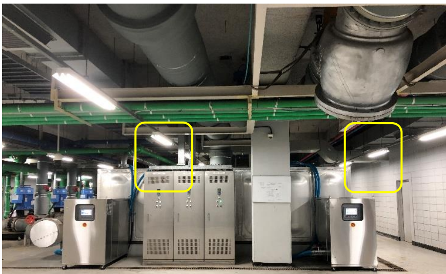
安裝照片 Installed Picture
